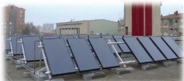
پنل‌های فتوولتائیک گرمایی هیبریدی در سوئیس
