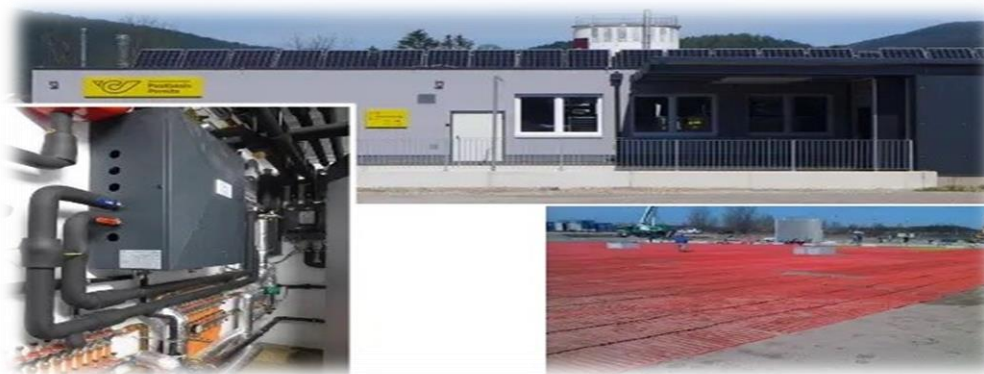
مرکز توزیع پست در پرینتز اتریش با یک میدان فتوولتائیک گرمایی هیبریدی در پشت‌بام و یک رجیستر پلیمری مستقر روی زمین بتنی
